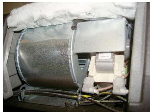
Figura n°28 - Acceso a los ventiladores
